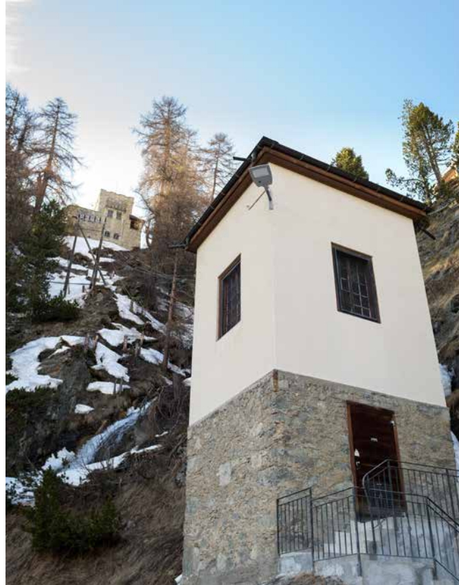
Blick von der Trafostation «Steffani» zur TS «Tinus» (o.), Trafoturm «Heimat» an der Ecke Via Ludains/Grevas (l.).
