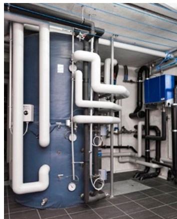
Speicher im Keller: Die Anlage hält das Wasser warm.
